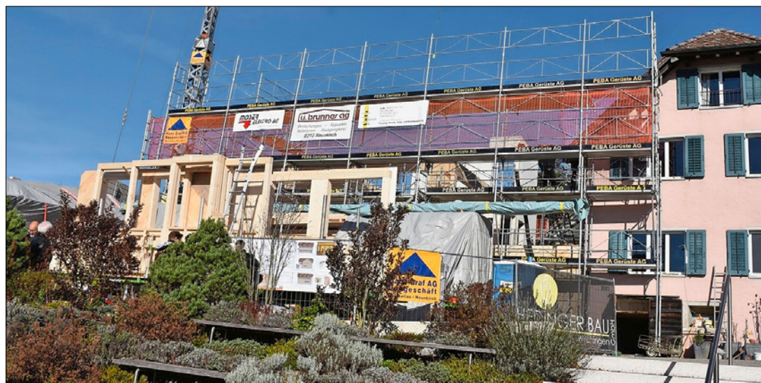
Auf dem Siblinger Randen entsteht zurzeit ein Holzbau mit Mehrzweckraum, Hofladen, öffentlicher Toilette und zwei Mietwohnungen. (Bild: Thomas Güntert)
